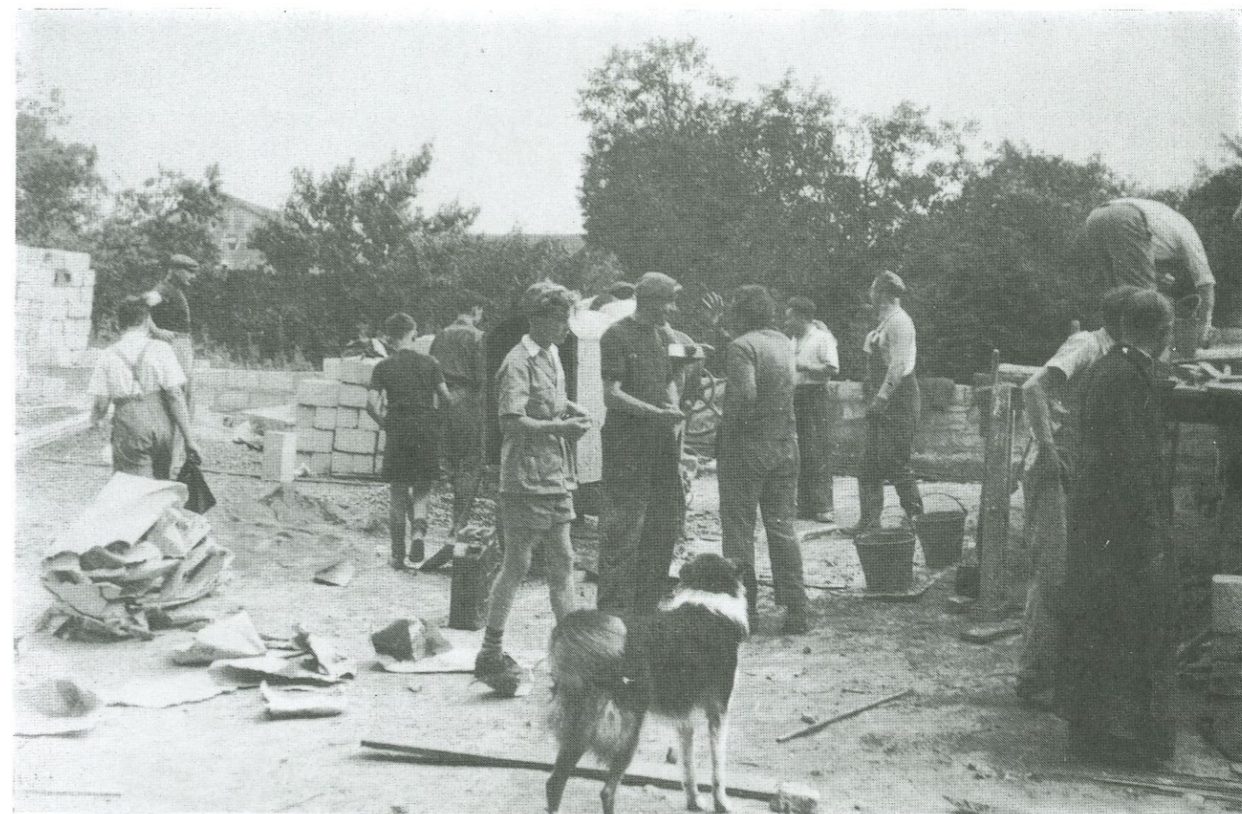
Construction de la salle paroissiale. Les travaux ont débuté le 1er mars 1952 et se sont achevés le 1er mai 1954. Plus de 150 hommes et femmes ont travaillé bénévolement à la construction.
